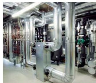
Abb. (v.l.n.r.): Kältemaschine, Druckhaltung des Kühlwassernetzes mit Wärmespeicherbecken, Hauptverteilung Kälte- und Wärmeversorgung
